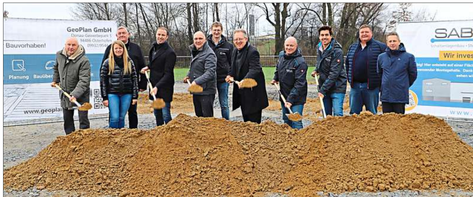
Spatenstich: Dritter Bürgermeister Ewald Straßer (v.l.), Kristina und Karl Heinz Groß (Tiefbau Groß), Robert Blöchl, Oliver Stockinger, Helmut Müller (alle GeoPlan), Bürgermeister Christian Mayer, SAB-Geschäftsführer Ralph Müller, Betriebsleiter Kevin Renner, Rainer Gebel (GeoPlan) und zweiter Bürgermeister Mathias Berger. – Foto: Diana Millgramm
